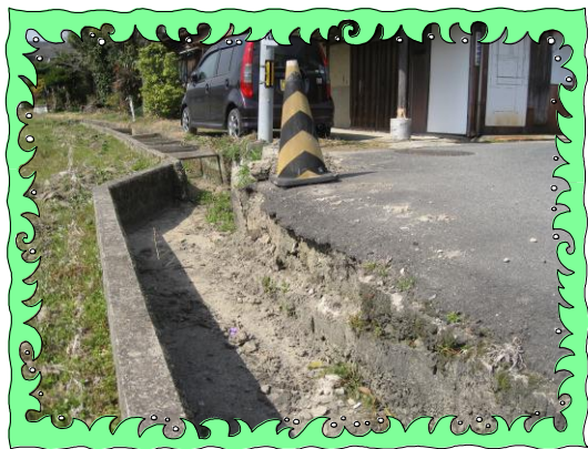
中矢原での工事〔補修前の道路の路肩〕
